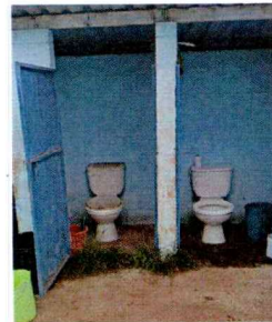
Foto4: Servicios sanitarios y sus accesorios
