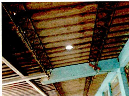
FOTO 2: EL TECHO DE DURALITA SE ENCUENTRA DETERIORADO TIENE AGUJEROS, PUES YA TIENE MAS DE 30 AÑOS DE INSTALADO
