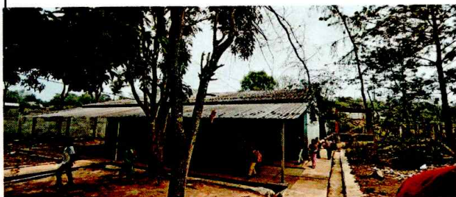
Foto1: REFUERZO DE ESTRUCTURA PORTANTE Y CAMBIO DE LAMINA DURALITA POR LÁMINA TROQUELADA CALIBRE 26.
