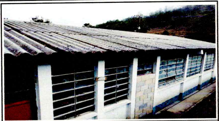
Foto 2: SE OBSERVA LA LAMINA DE FIBROCEMENTO EN MAL ESTADO
