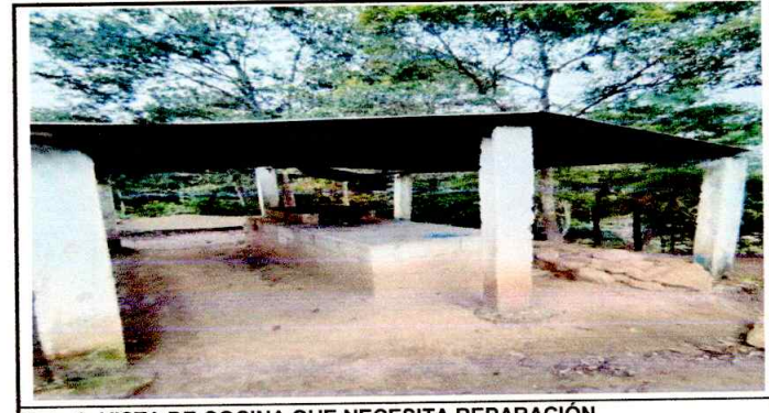
Foto 6: VISTA DE COCINA QUE NECESITA REPARACIÓN.
