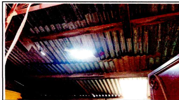
Foto: 3 Lamina rota con varios daños
