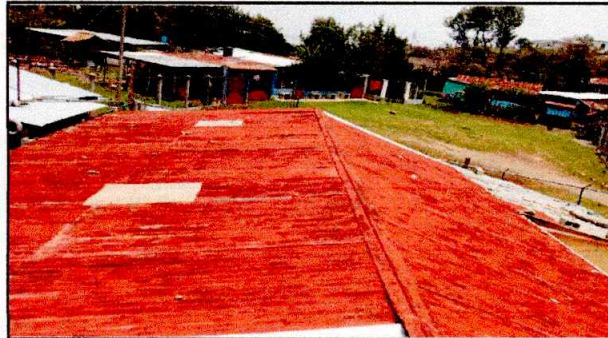
Foto: 1 Lamina presenta daños por antigüedad
