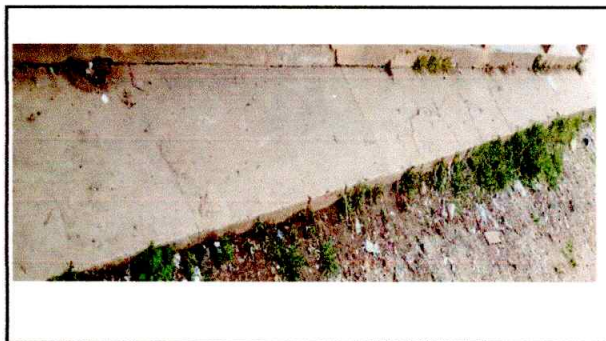
Foto: 4 Losa de patio agrietada
