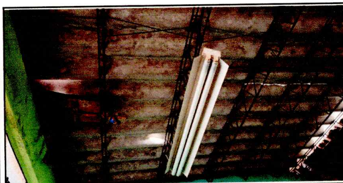
Foto: 5 estructura de lamina en mal estado
