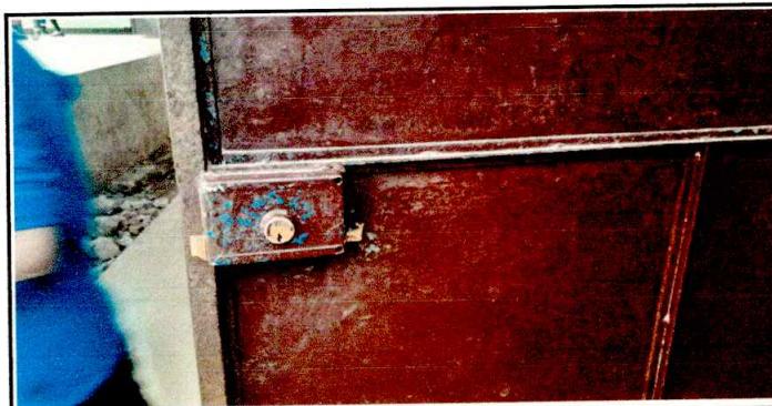
Foto: 6 Se observa chapas de puerta en mal estado
