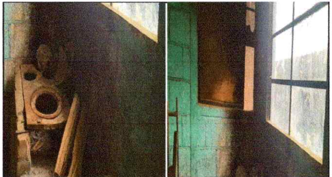
Foto 4: COCINA RURAL Y VENTANAS EN MALAS CONDICIONES
