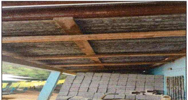
Foto 2: SE OBSERVA COSTANERA DE MADERA EN MAL ESTADO
