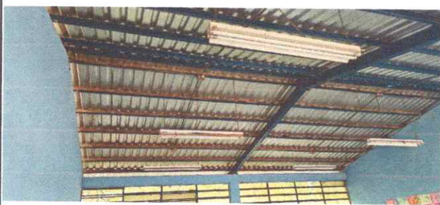
Foto 5: Alumbrado de lámparas en mal estado.
