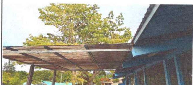
Foto 2: Lamina insuficiente en cobertura.
