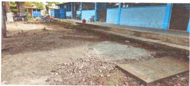
Foto 1: Losa de patio totalmente destruida.
