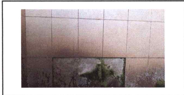
Foto 6: Azulejo de baños en mal estado
