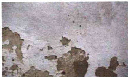
Foto 13: Repello de paredes de baños dañada
