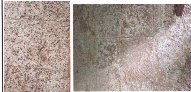
Foto 12: piso de aula dañado
