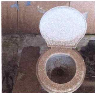
Foto 11: piso de baños en mal estado
