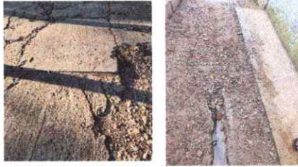
Foto 7: Losa de patio en mal estado.
