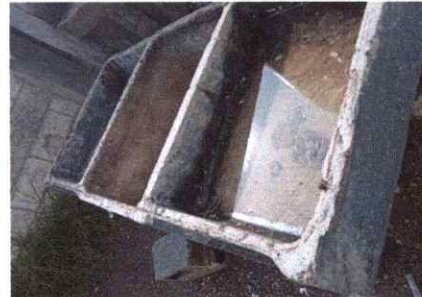
Foto 10: depósito de agua en mal estado
