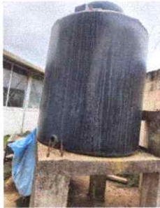
Foto 9: Rotoplás en mal estado
