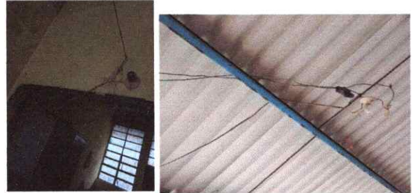
Foto 8: Sistema eléctrico dañado
