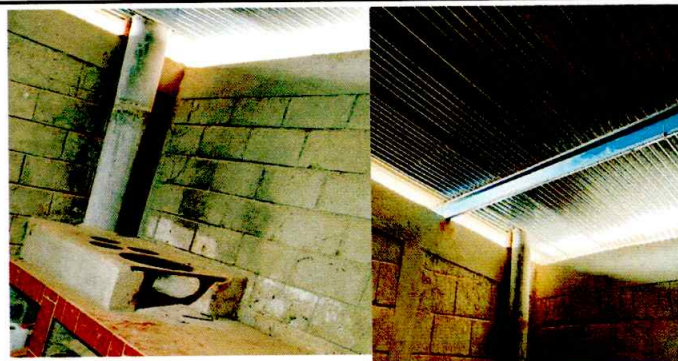
Foto 10 : Se observa estufa rural, chimenea deteriorada y falta de lamiluz para una perfecta visibilidad
