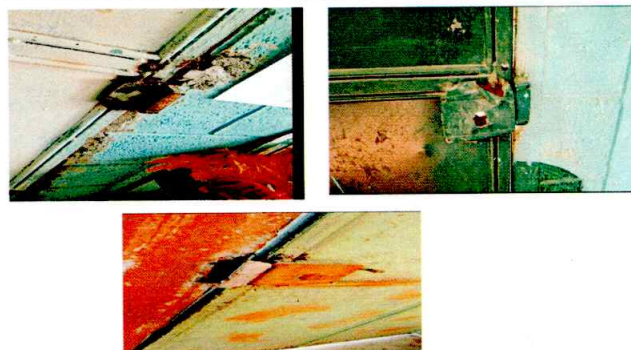
FOTO 8: Se observó chapas de puertas en mal estado.
