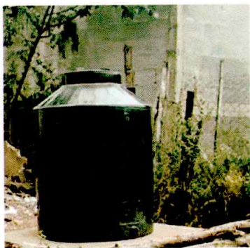
Foto7: Tinaco deteriorado con falta de instalación adecuada.
