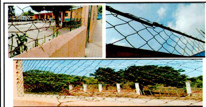
Foto: 5 Se observa malla metálica deteriorada y oxidadas.
