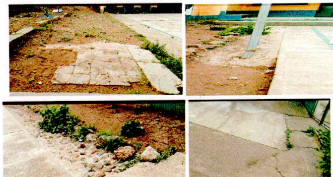
Foto 9: Se observa losa de patio pavimentación en mal estado.
