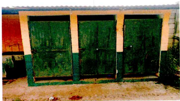
Foto: 11 Puertas de sanitarios en mal estado
