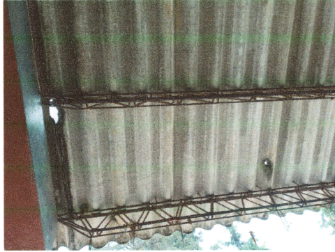
Foto1: Se puede evidenciar el deterioro del techo por el paso de los años
