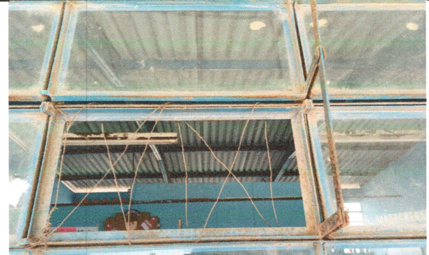
Foto4: Se puede observar falta de vidrios y ventanales en mal estado
