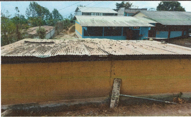
Foto3: El techo ya se encuentra oxidado
