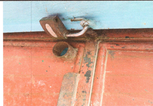
Foto 6: Se puede observar la falta de chapas en algunas puertas del centro educativo
