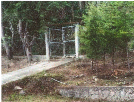
Foto1: Se puede observar que el porton de entrada principal es de maya y una parte se encuentra detenida con piedras.
