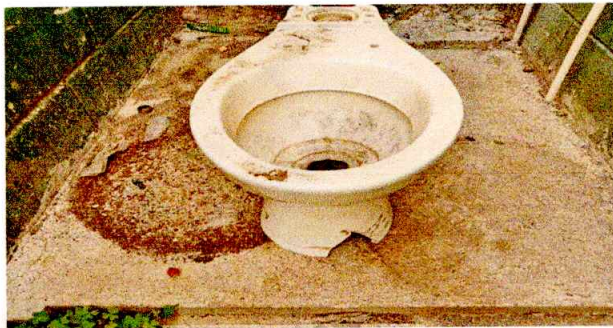
Foto: 5 SE PUEDE OBSERVAR SANITARIO DAÑADO
