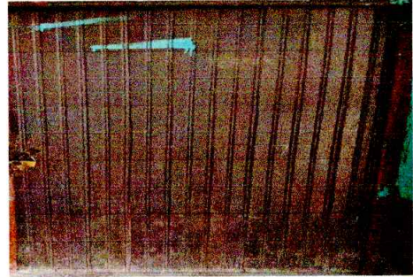
FOTO 2: SE PUEDE OBSERVAR PUERTA DAÑADA
