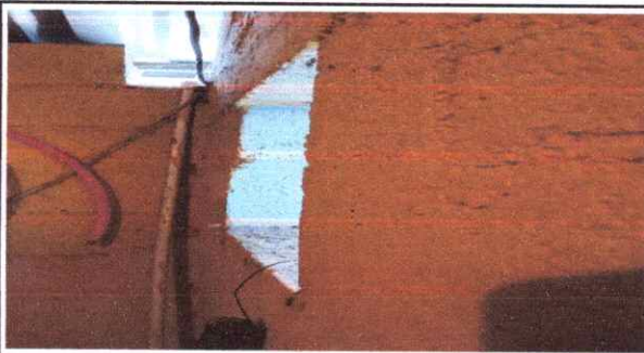
Foto 3: FALTA DE VENTANA DE METAL
