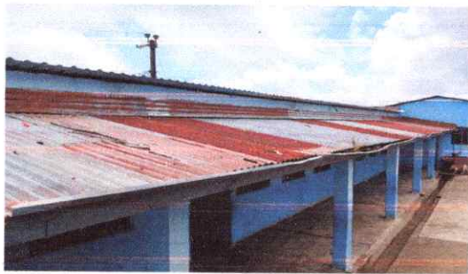
Foto1: SE OBSERVA LAS LÁMINAS OXIDADAS
