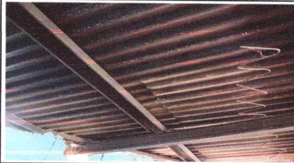
Foto 2: SE OBSERVA LA ESTRUCTURA DE TECHO DAÑADO
