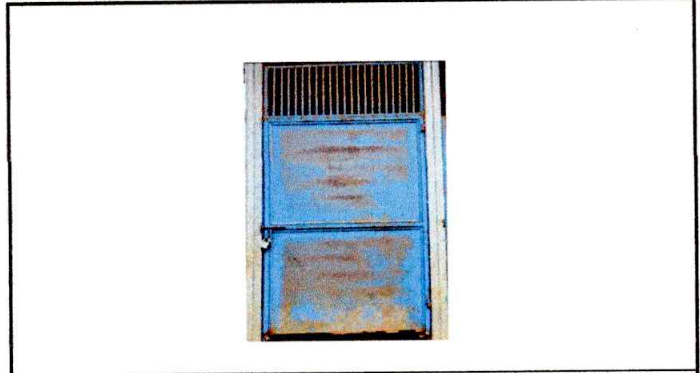
Foto 2: SE OBSERVA PUERTA DE SANITARIO EN MAL ESTADO
