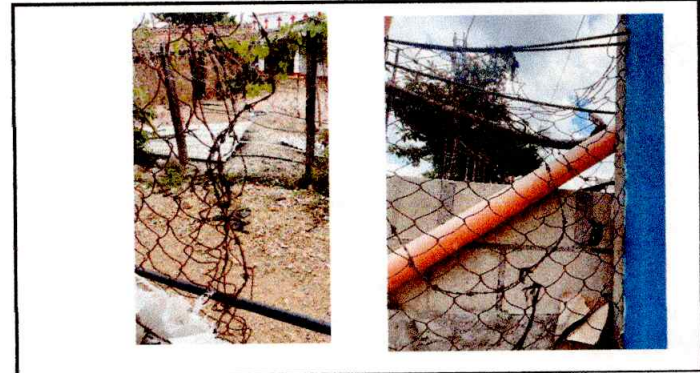
Foto 4: SE APRECIA EL ESTADO DE LA MALLA Y SU ANCLAJEA DE MURO, EN MAL ESTADO
