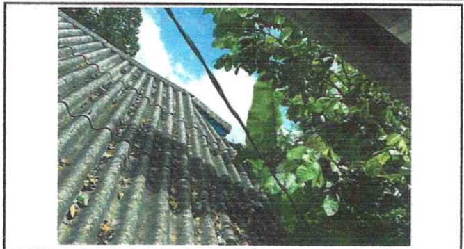
Foto 2: Se observa la necesidad de cambiar completamente el techo, presente varias abolladuras y se debe evitar riesgo que se caiga y ocasione accidentes a los alumnos.
