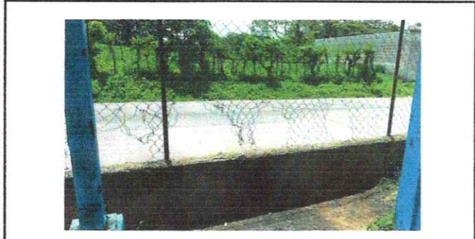
Foto 3: Se evidencia la necesidad de reparar la malla, para evitar que personas ajenas entren a las instalaciones y mantener el resguardo necesario.
