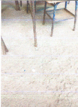
Foto 3: Torta de cemento en malas condiciones.
