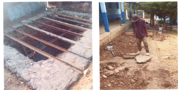
Foto 6: Reparación de drenajes y losa de patio
