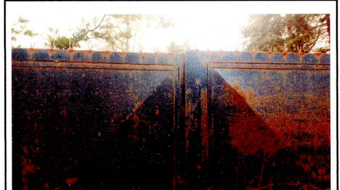
Foto 4: se observa portón en mal estado, el cual necesita reparaiación y mantenimiento.
