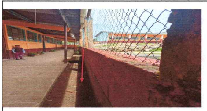
vencimiento de muro de contencion al frente de las aulas de cuarto y quinto grado de la EORM JM Aldea La Pastoria Jalapa. 1 metro con 10 centimetros de
