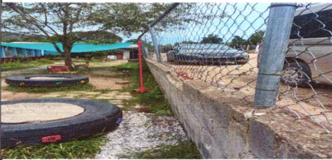
vencimiento de muro de contencion al (frente) de la EORM JM Aldea La Pastoria Jalapa, 1 metro con 20 centímetros de alto
