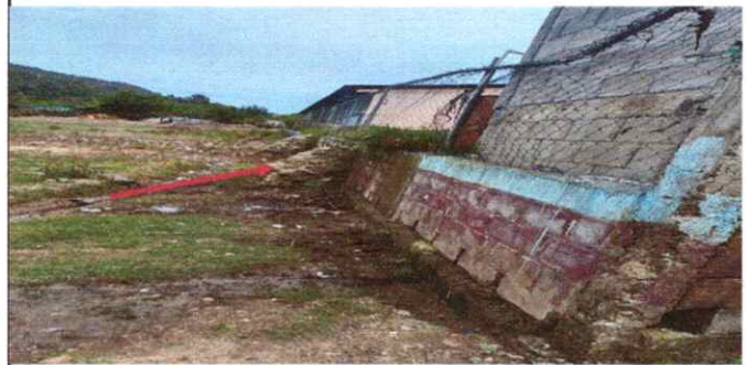
vencimiento de muro de contencion en la parte de atrás de la EORM JM Aldea La Pastoria Jalapa. 1 metro con 15 centrimetros de alto.
