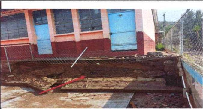
daños por lluvias, derrumbe en el muro de contencion al frente de las aulas la EODP anexa a EORM JM Aldea La Pastoria Jalapa
