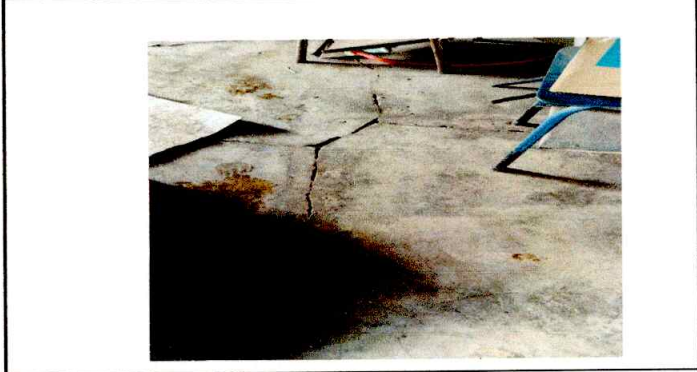
FOTO 2: SE OBSERVA GRIETAS EN TORTA DE AULA
