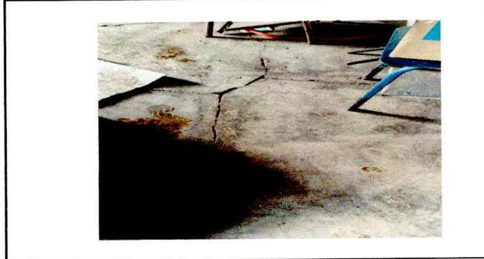
Foto4: SE OBSERVA GRIETAS EN TORTA DE AULA
