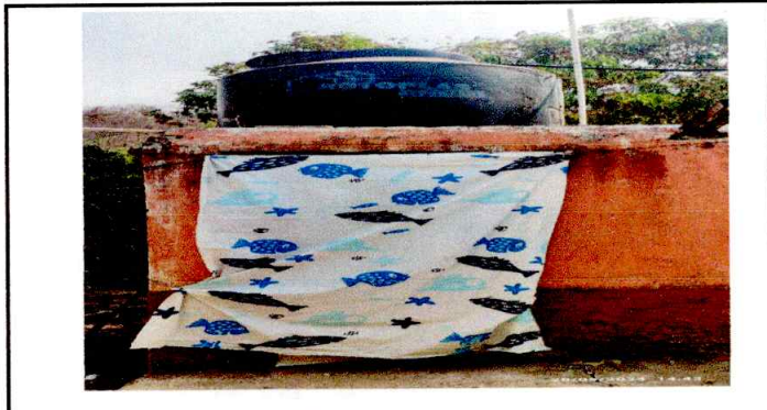
Foto3:SE OBSERVA DEPOSITO EN MAL ESTADO Y BASE DE DEPOSITO EN MAL ESTADO
