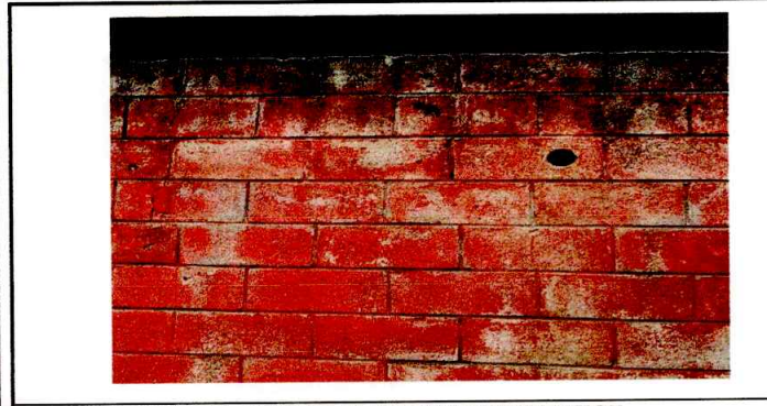
Foto: 5 SE OBSERVA OYOS EN EL MURO DE CONTENCIÓN
