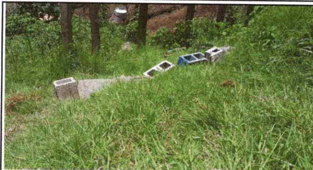
Foto 2: ES NECESARIO EL MURO PERIMETRAL
