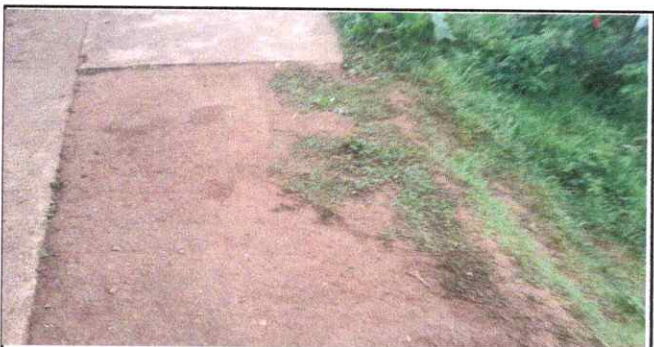
Foto 3: SE NECESITA SUSTITUCION DE LOSA D PATIO
