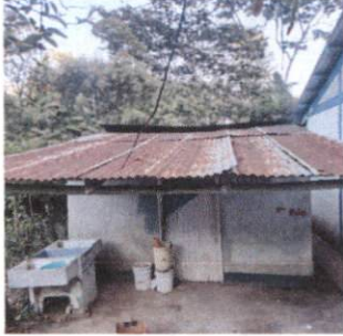
Foto No. 1. Lamina de la cocina en malas condiciones
