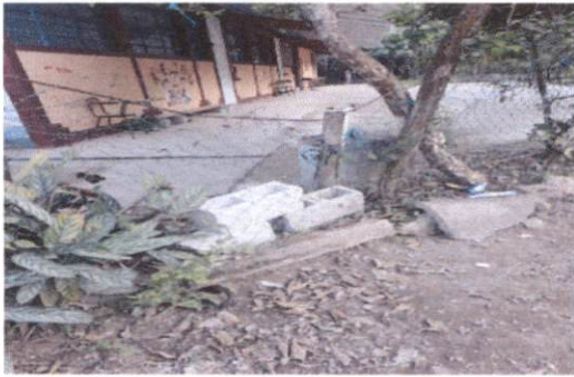
Foto No 3. Muro perimetral en malas condiciones
