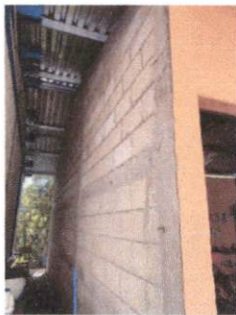
Foto No. 5. Pintura en malas condiciones
