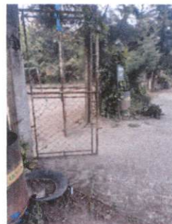
Foto No. 6. Losa de patio en malas condiciones
