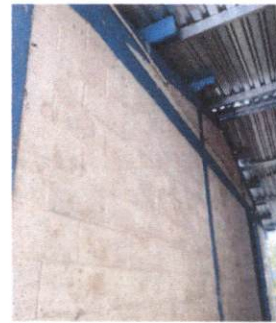
Foto No. 4. Pintura en malas condiciones
