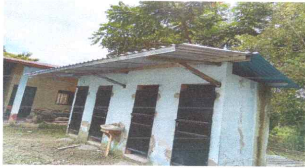
FOTO 1: CAMBIAR PUERTAS DE BAÑOS
