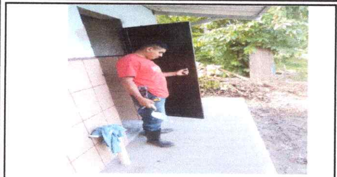
FOTO 1: CAMBIAR PUERTAS DE BAÑOS
