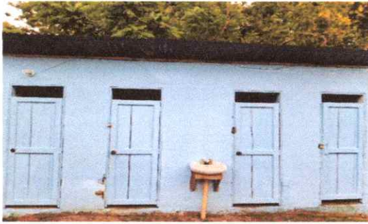
FOTO 1: CAMBIAR PUERTAS DE BAÑOS
