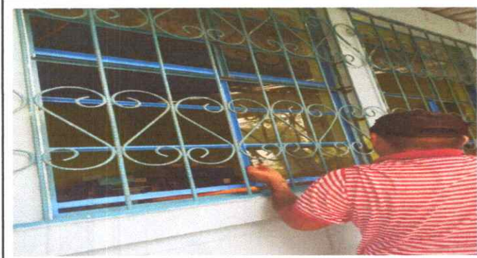
Cambio de estructura metálica de ventana y ventanas de vidrio rotas por estructura metálica y vidrio.
