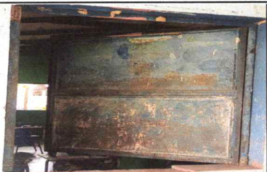
3) VENTANAS DETERIORADAS, OXIDADAS Y DESAJUSTADAS
