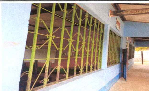
4) BALCONES CON ÒXIDO Y DESAJUSTADOS
