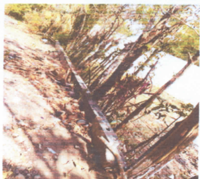
REPARACIÓN DE MURO PERIMETRAL DE BLOCK CON TUBO HG Y MALLA GALVANIZADA, SOLERAS INTERMEDIAS Y COLUMNAS
