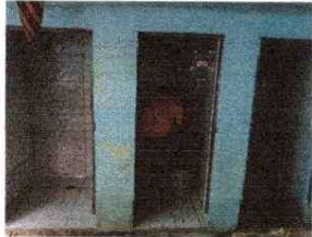
Foto 5: Servicios sanitarios y sus accesorios
