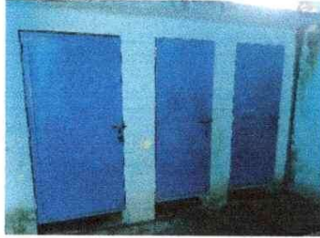
Foto 5 Servicios sanitarios y sus accesorios
