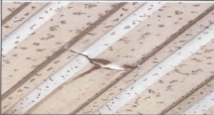
Foto 1: Goteras en salón de usos múltiples, por perforaciones y mal estado de las láminas.
