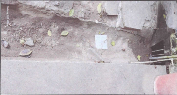
Foto 7: Cuneta de concreto en mal estado.
