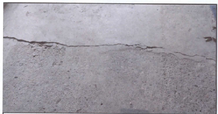
Foto 6: Torta de cemento en mal estado al ingreso del establecimiento.
