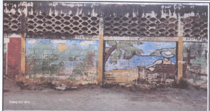
Foto 8: Muro perimetral en mal estado con requerimiento de pintura.
