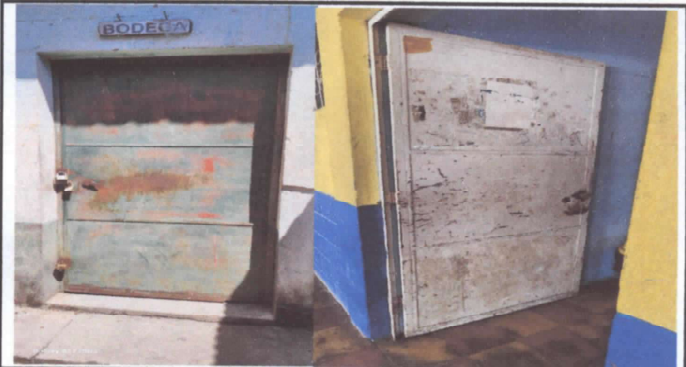
Foto 2: Deterioro en puertas de todos los salones de clases y área de bodega y sanitarios.
