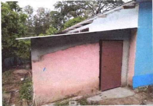
Foto 1: REMOZAMIENTO ESTRUCTURAL EN ÁREAS DE BAÑO, SUSTITUCIÓN DE LÁMINA TROQUELADA ALUZINC CALIBRE 26
