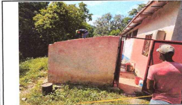
Foto 1: REMOZAMIENTO ESTRUCTURAL EN ÁREAS DE BAÑO, SUSTITUCIÓN DE LÁMINA TROQUELADA ALUZINC CALIBRE 26
