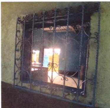
MANTENIMIENTO DE ESTRUCTURA DE METAL DE VENTANA (COCINA)
