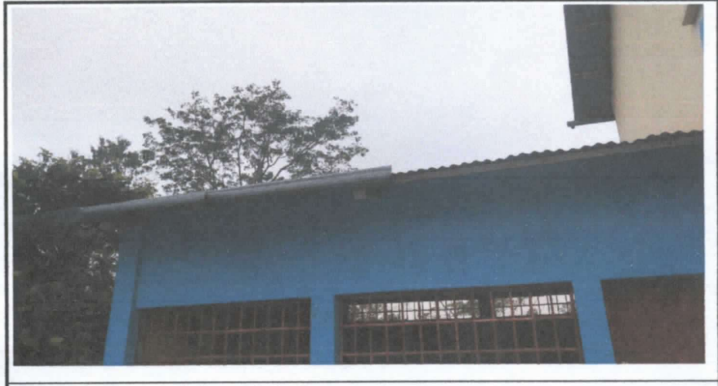
Canaletes Incompletos y dañados.
