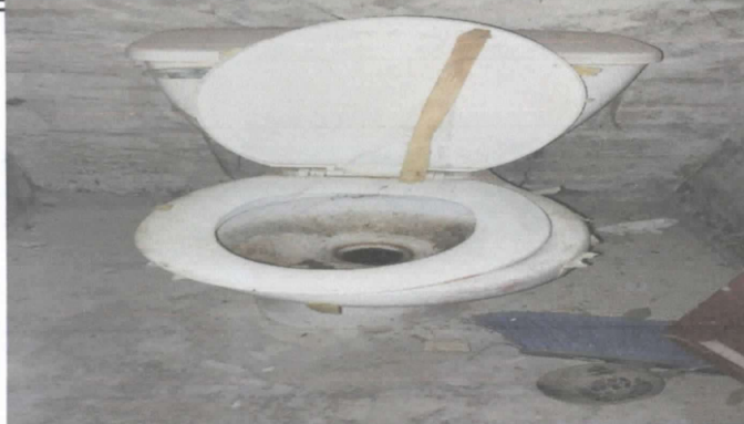
Sanitarios fuera de servicio
