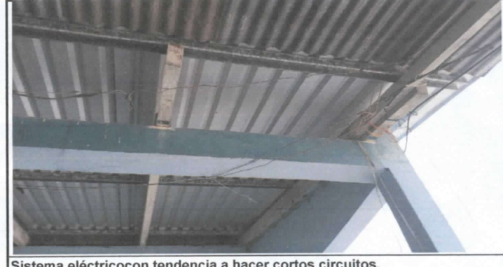
Sistema eléctrico con tendencia a hacer cortos circuitos.
