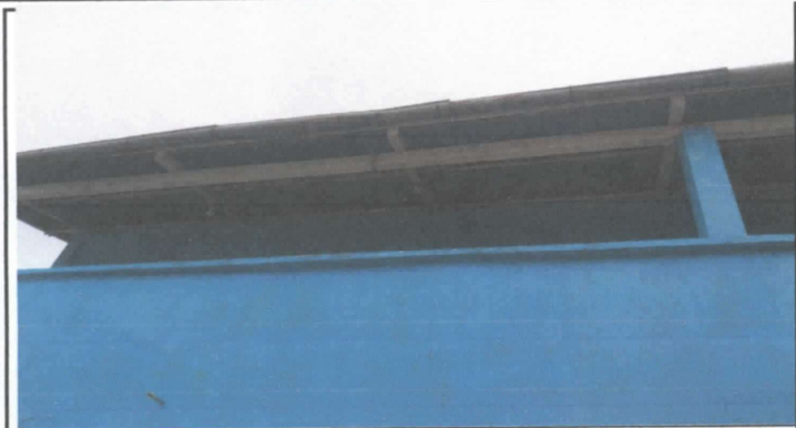
Canaletes se han picado y no cumplen su función y se encuentran incompletos.
