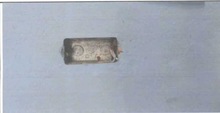
No se cuenta con tomacorrientes ni interruptores.
