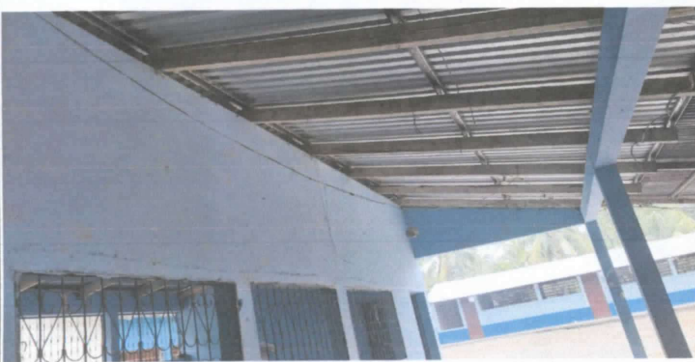
Sistema electrico carecienteeo nulo en algunos espacios.
