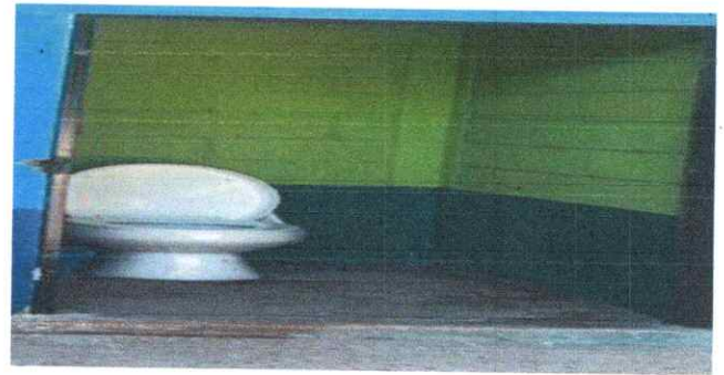
Foto 4: Accesorios en baños
