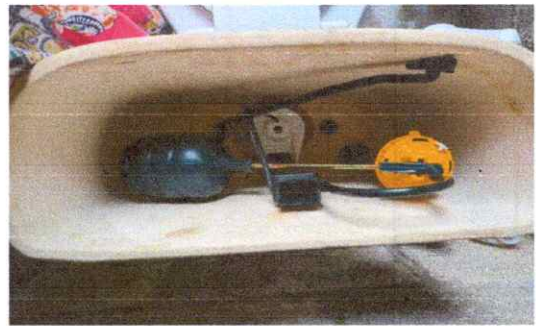
Foto 4: Accesorios en baños
