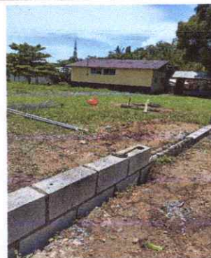
REPARACIÓN DE MURO PERIMETRAL DE BLOCK CON TUBO HG Y MALLA GALVANIZADA, SOLERAS INTERMEDIAS Y COLUMNAS.
