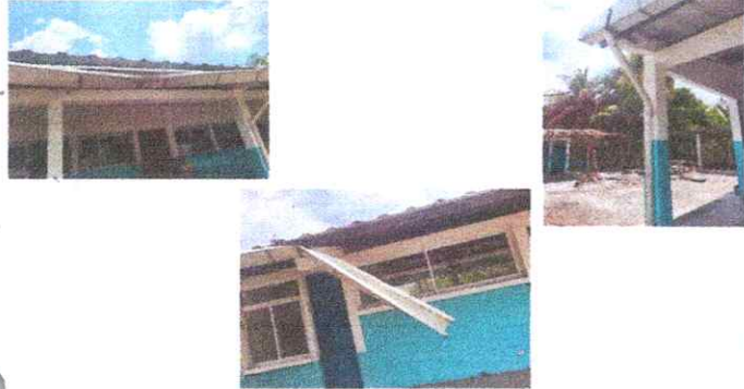
canales y bajadas de agua puvial: canales
