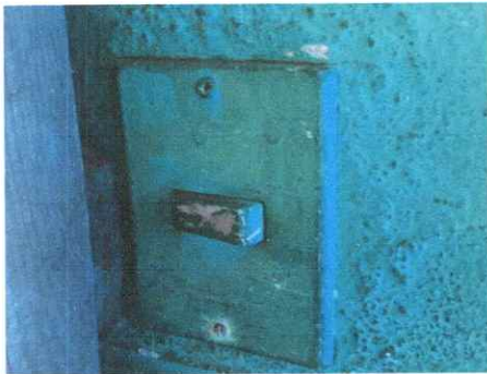
Sustitución de interruptores simples
