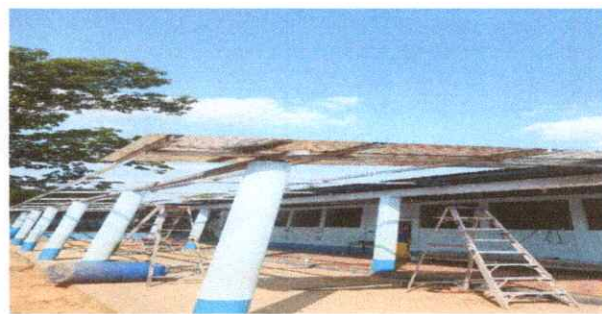
Foto 4: Reparación e instalación del nuevo techo el cual será de gran utilidad a la comunidad educativa.
