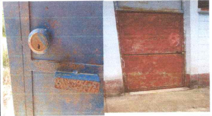
se necesita sustituir las puertas debido al deterioro
