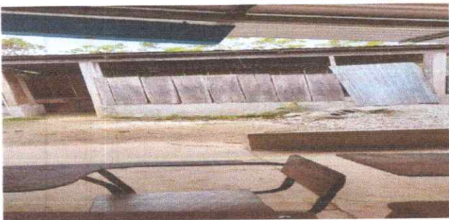
las paredes de la cocina estan en mal estado por lo que es necesario repararla
