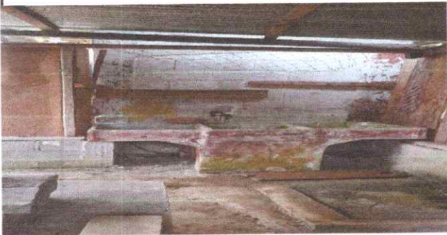
se necesita reparar el piso debido al mal estado en que se encuentra la cocina
