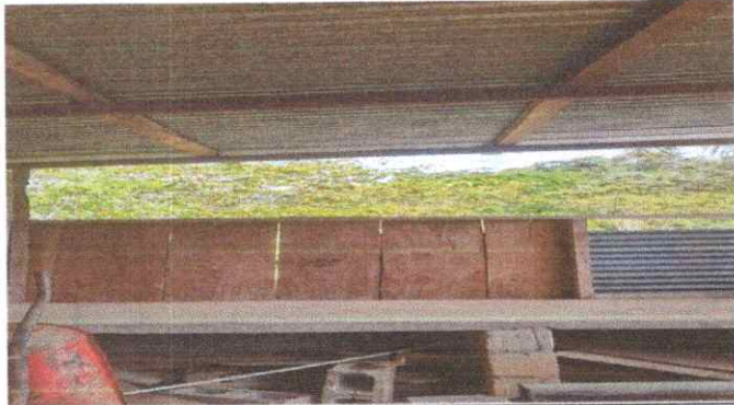
El techo de la cocina necesita ser reparado su lámina y su estructura debido a lo debil del soporte
