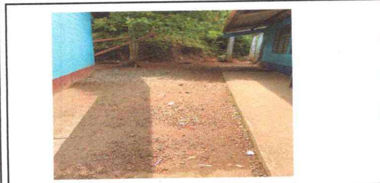
Foto 3: Torta de concreto
