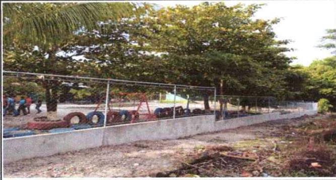
Foto3: Reparación de muro perimetral de block con tubo hg y malla galvanizada, soleras intermedias y columnas.
