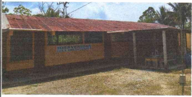
FOTO 1: TECHO EN MAL ESTADO
