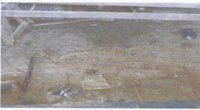
Piso en mal estado
