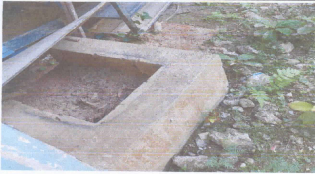
Hornilla en mal estado
