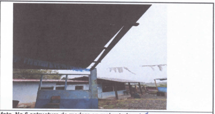
foto No.6 estructura de madera en mal estado.
