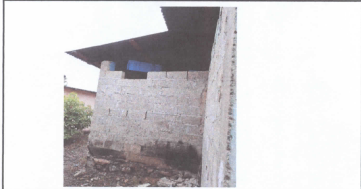
Foto No.1 Pared en mal estado.
