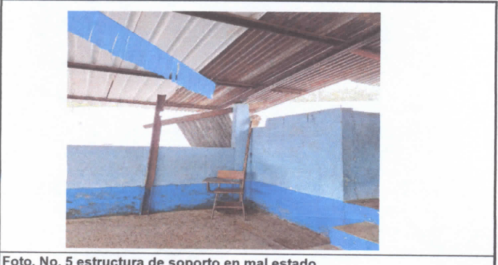
Foto No. 5 estructura de soporte en mal estado
