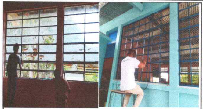
Foto 2: Sustitución de vidrios en ventanas por balcones de metal y malla galvanizada
