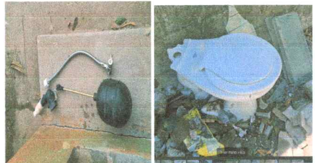
Foto 4: Servicios Sanitarios y Accesorios
