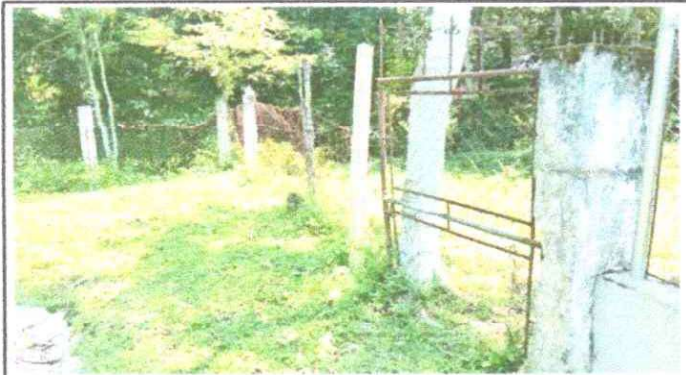
MALLA DEL PERIMETRO EN MALAS CONDICIONES
