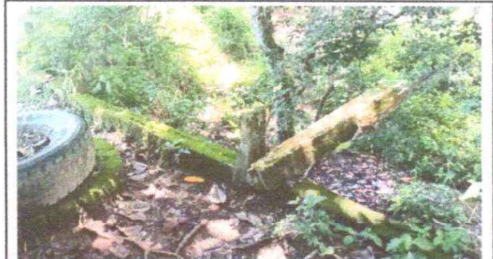
BASES DEL MURO PERIMETRAL CAÍDAS
