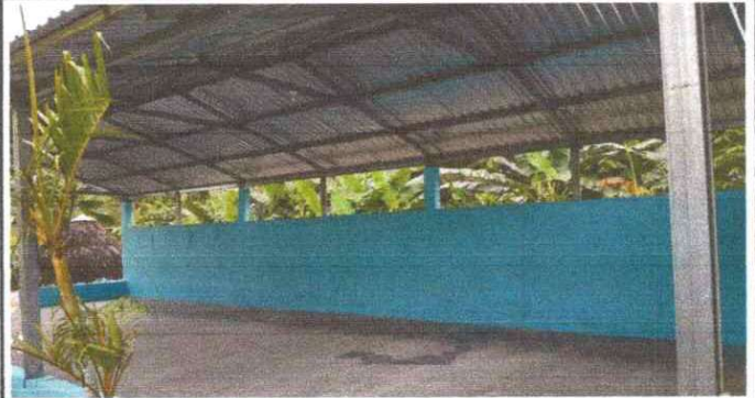
Foto 2: Se finalizan los trabajos de Sustitución de estructura de soporte de madera, por metal
